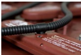
Tubería sin abrazaderas
